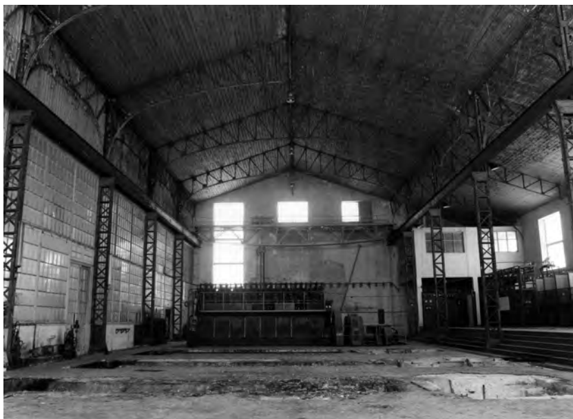
Fig. 4 – Estado de degradação da nave industrial antes da intervenção
